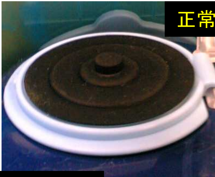
排気弁の劣化
